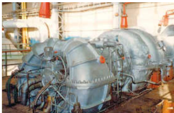
Рис. 1. Газотурбинная установка ГТК-10
