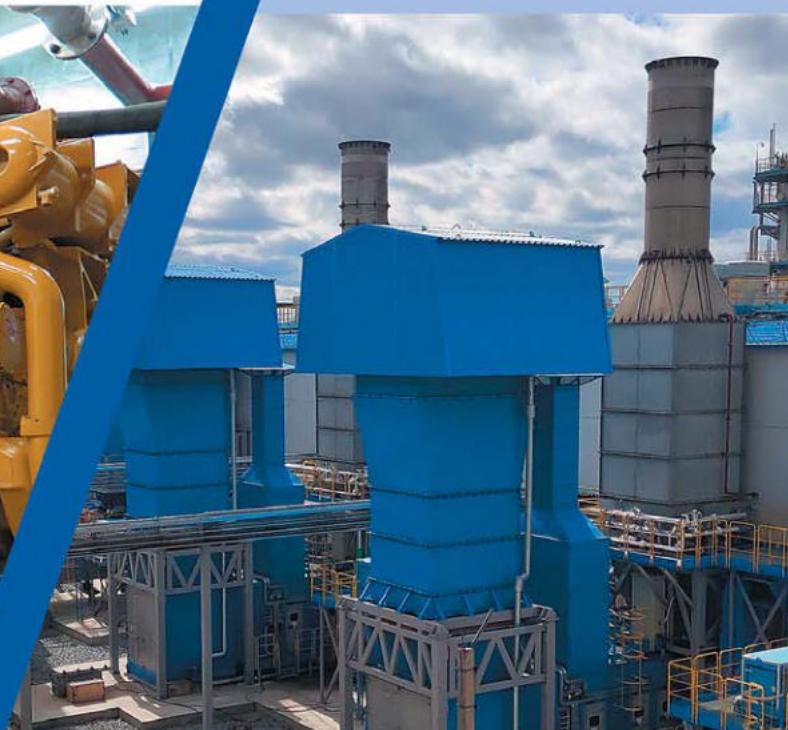
ГПА-6 МВт и ГПА-10 МВт «Иртыш», 1 шт. и 2 шт. ДКС Уренгойского ЗПКТ, ООО «Газпром переработка»
